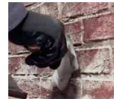
▲ 5. Verschließen Die Bohrlöcher werden schnell mit einem mineralischen Mörtel (z. B. Secco Waterproof) verschlossen
